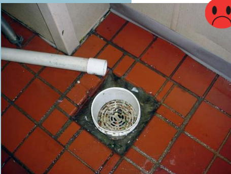
2.2.4 Drain non aligné
