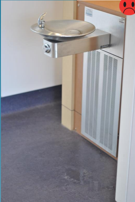
2.1.3 Flaque d'eau près d'une fontaine
