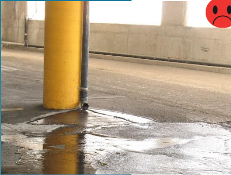
2.2.1 Tuyaux non alignés
