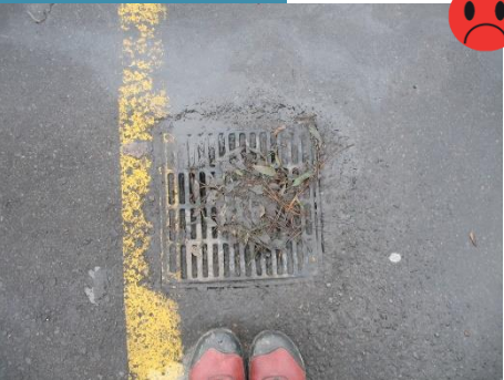
2.2.2 Drain obstrué par des débris
