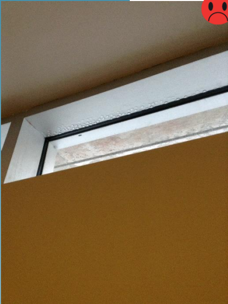
2.10.2 Condensation autour d'une fenêtre
