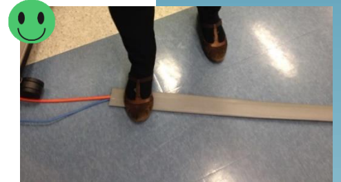
2.9.7 Câbles partiellement fixés au plancher au moyen d'un cache-câbles
